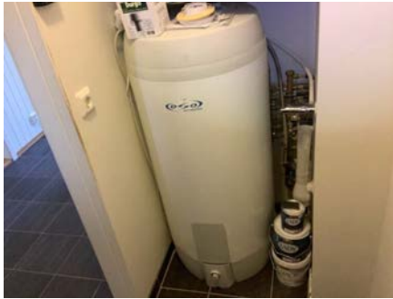
Varmtvannsbereder på 200 liter er plassert i garderobe.
