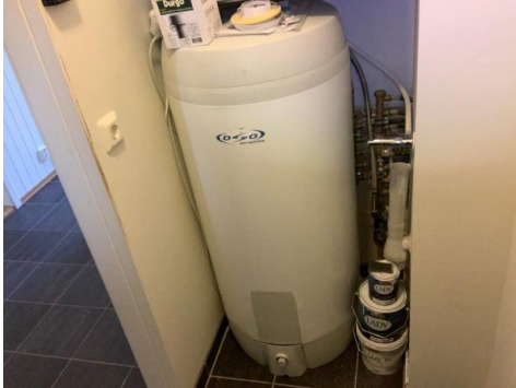
Varmtvannsbereder på 200 liter er plassert i garderobe.
