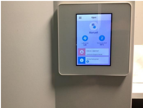
Aggregat viser to feilkoder. Kan være tid for filterbytte. Anbefaler undersøkelse av disse.
