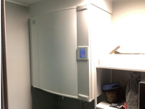
Balansert ventilasjon med gjennvinner.
