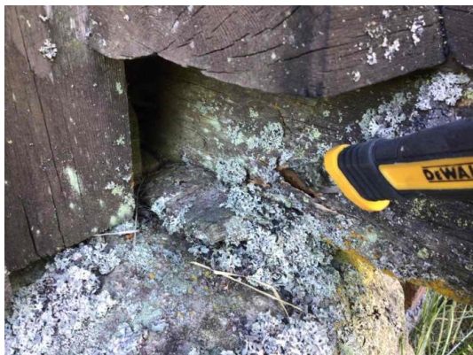
Lokale råteskader i tømmer og kledningsbord.
